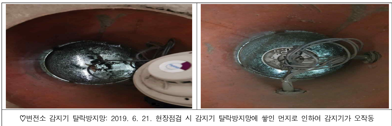
[사진] 임의로 설치한 감지기 탈락방지망 오염 사례
