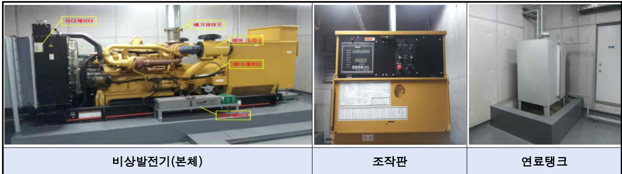
[사진 1] 비상발전기 사진
