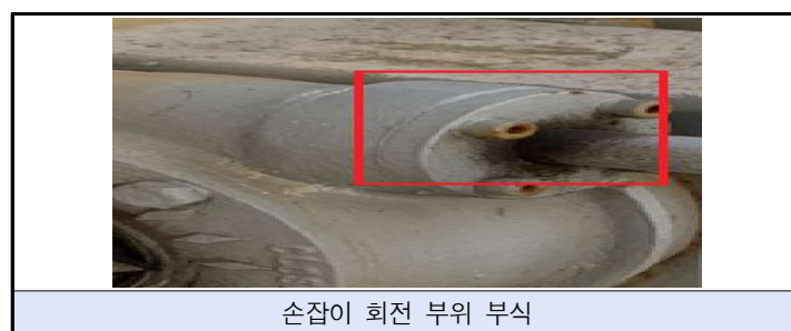
[사진 6] 고압산소 배관에 설치된 볼밸브 관리상태
