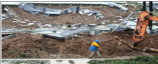
청도 태양광발전시설 산사태('18.7월)
