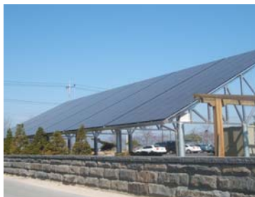
[강원 춘천 30kW급 태양광발전]
