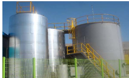
[축산분뇨 가스화 발전설비(형기소화조)]
