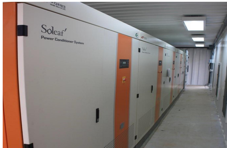
〈 당사 인버터 설치 사진 〉
