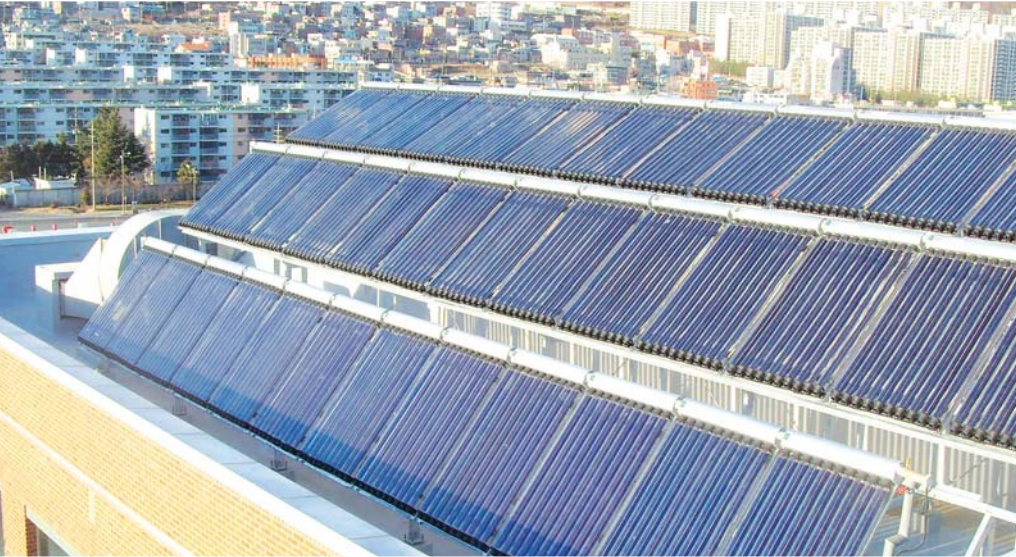
Solar thermal heating system in Yang san
