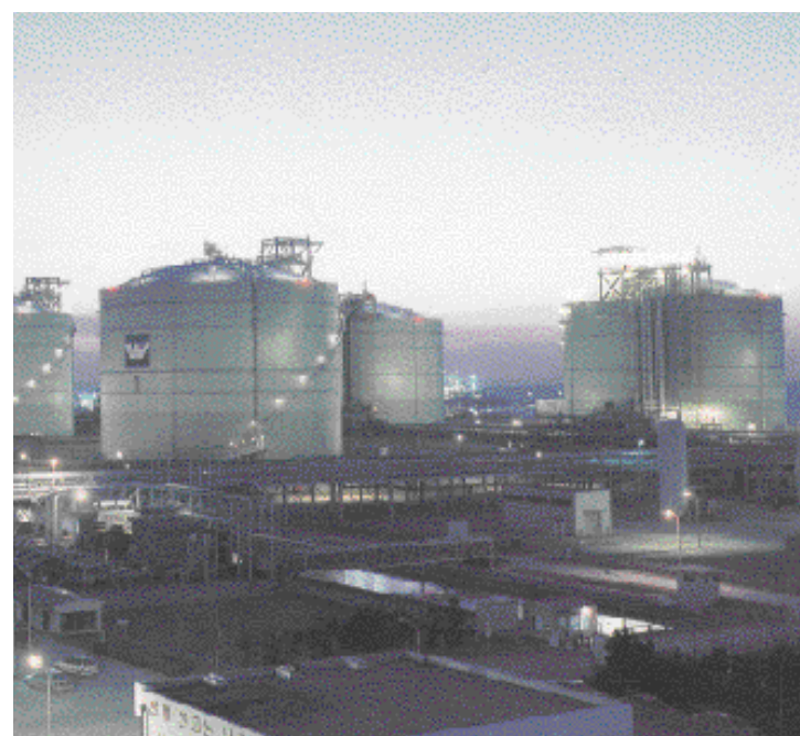
LNG Terminal in Pyung-taek
