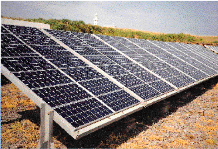
▼ 태양광 발전시스템 (제주도 남제주군 마라도)
